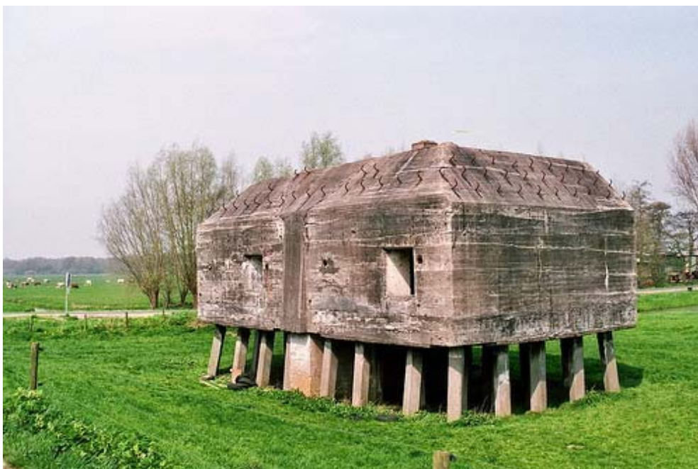
Figuur 2.1: Bodemdaling: bodem is gedaald, gefundeerde bunker is blijven staan
